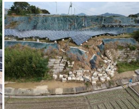
法面保護工が崩れて流出した事例
