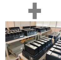
ドローンのバッテリー充電施設
