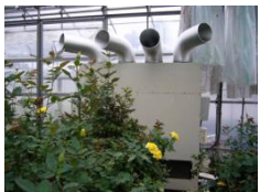
施設園芸用ヒートポンプ
