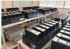
バッテリー保管・充電施設
