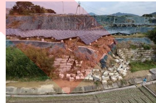
法面保護工が崩れて流出した事例
